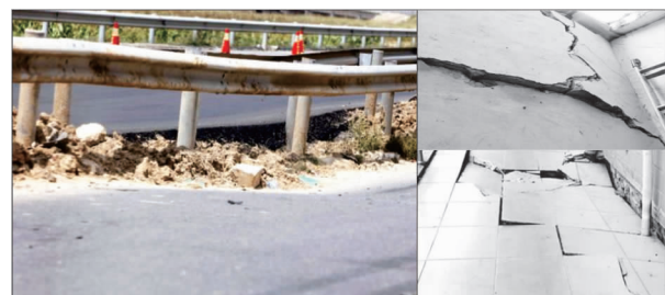
(a)湿陷性黄土导致路基沉降,兰州 (b)湿陷性黄土导致建筑物开裂,兰州
